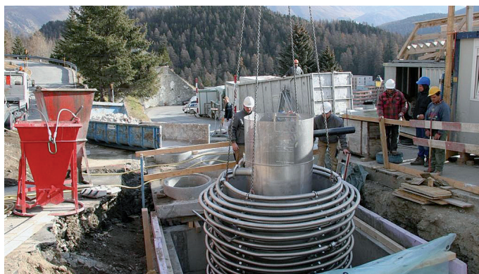
Ten wymiennik ciepła umieszczony w zbiorniku przepompowni ścieków służy jako źródło dolne pompy ciepła podgrzewającej c.w.u.
