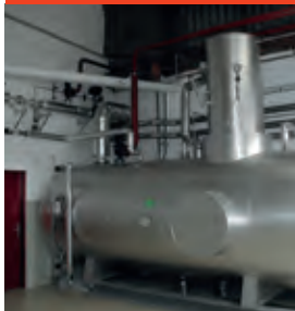
Instalacja termicznego odgazowania pełnego
