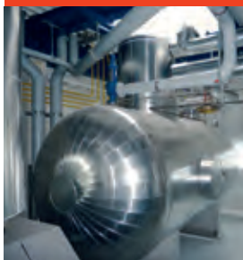
Instalacja termicznego odgazowania pełnego
