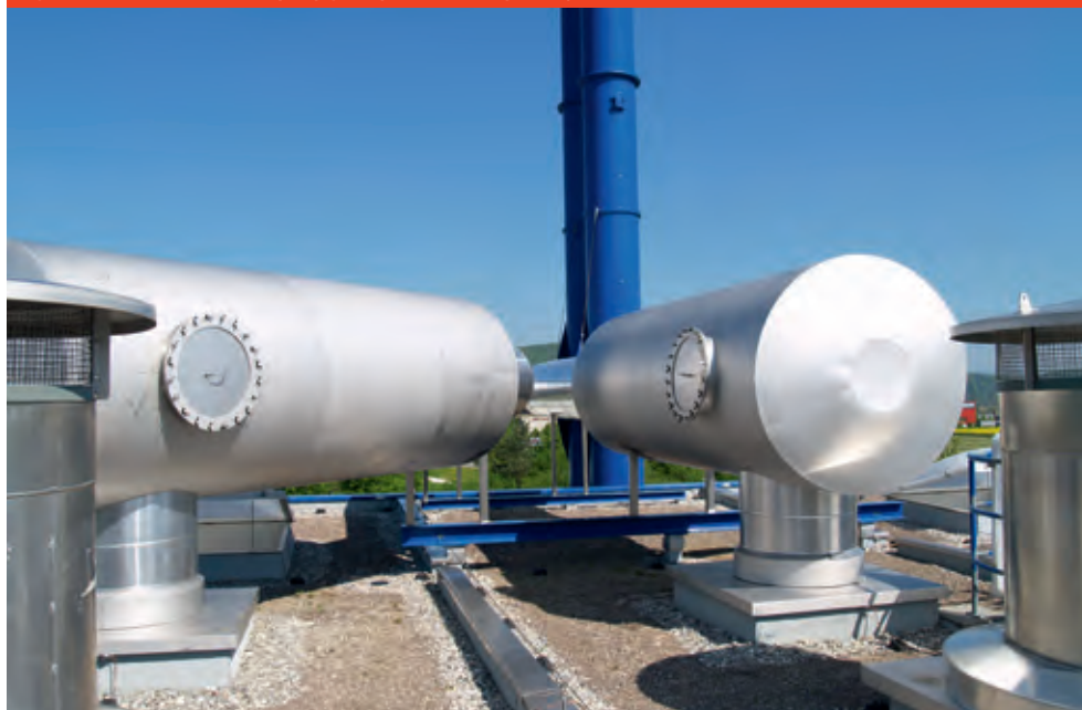
Rys. C.10-2 Tłumiki szumów przepływu spalin kotłowni parowej
