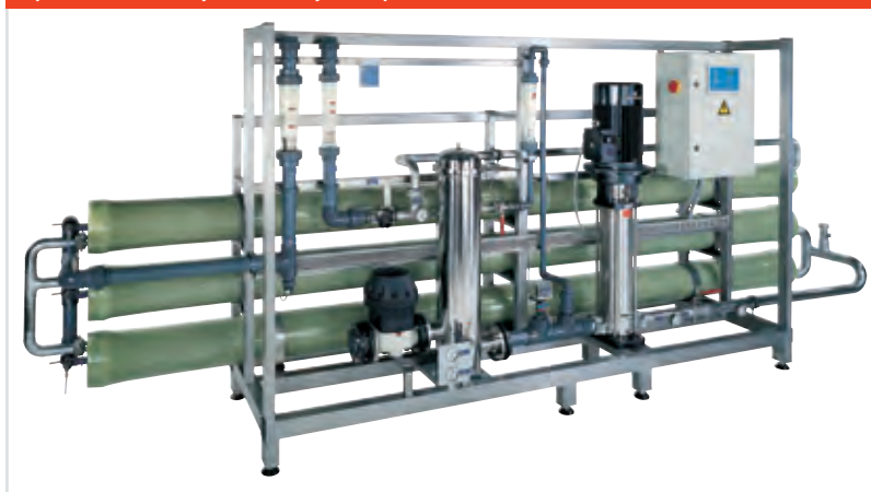
Rys. C.5.2-1 Instalacja odwróconej osmozy
