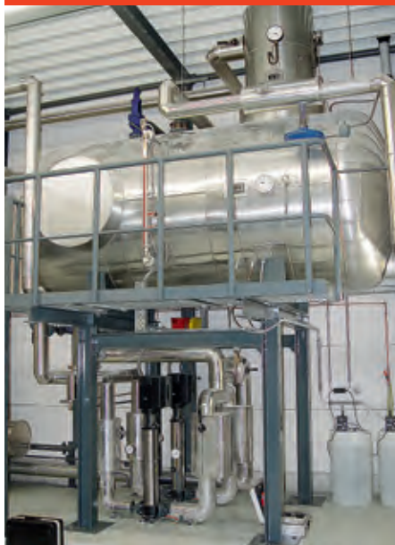
Zbiornik wody zasilającej z umieszczonym na nim odgazowywaczem ociekowym
