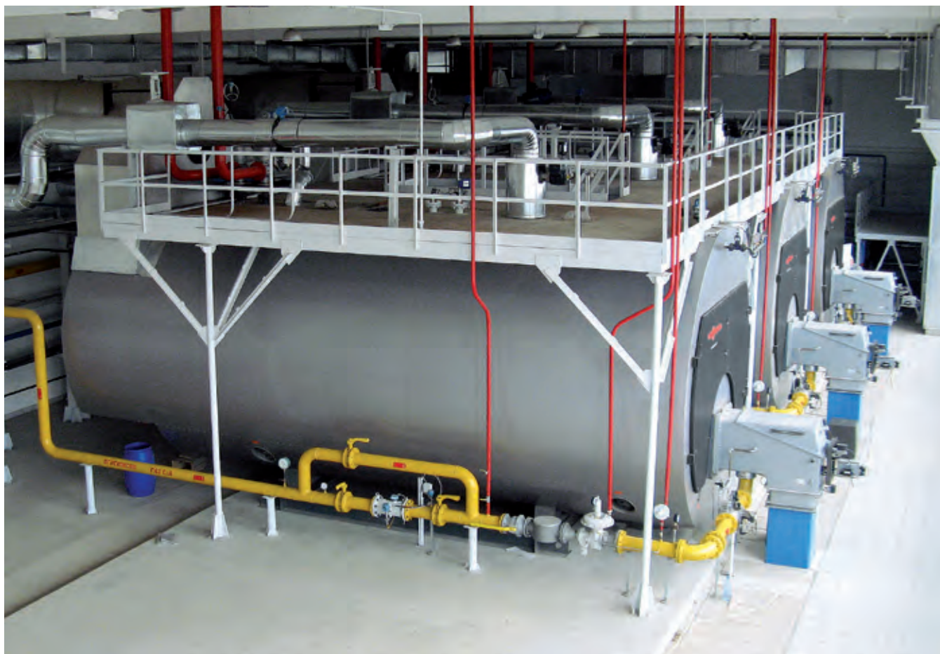
3 kotły Vitomax 200-HS typu M235
