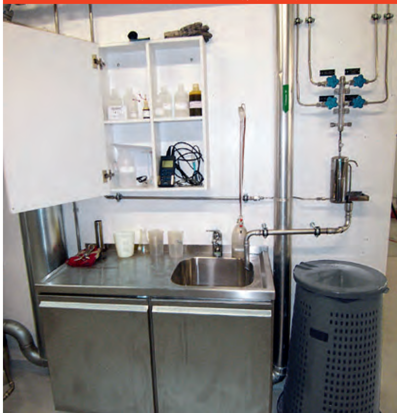
Rys. D.75.1-1 Stanowisko analizy jakości próbek wody zasilającej i kotłowej
