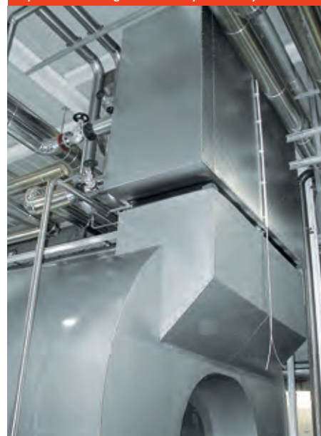
Rys. D.2.3-4 Podgrzewacz wody ustawiony na kotle
