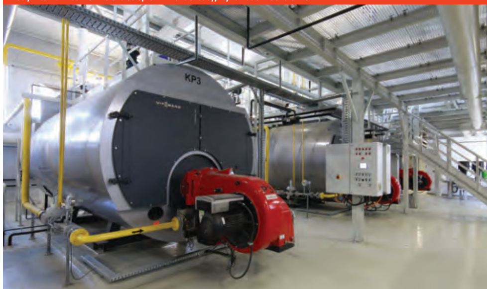
Kotły Vitomax 200-HS w elektrociepłowni kondensacyjnej zakładów Sokół S.A.
