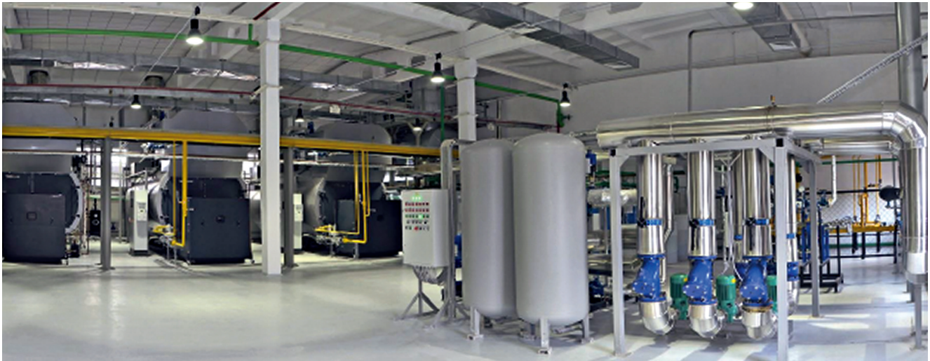
Centrala energetyczna z kotłami Vitomax. Można je już opalać w 100 procentach czystym wodorem.
